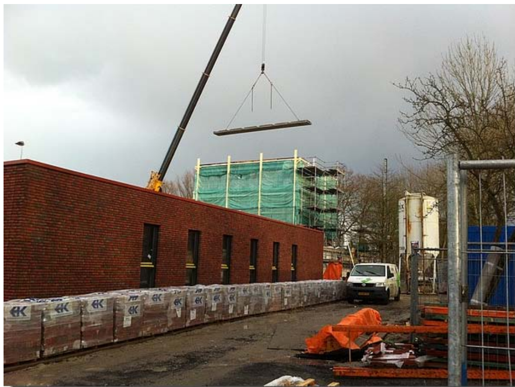
Het plaatsen van 5 ton zware prefab betonnen dakvloer van het 12 meter hoge aula.
